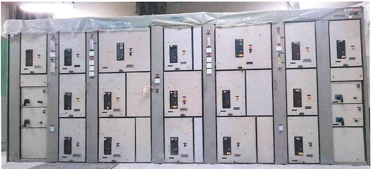
Fig.4.Pamje e paneleve te impiantit shperndares egzistues 0.4kV
