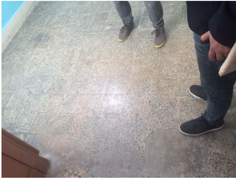
Figure 11 Mungesa e pllakave në ambientet e gjimnazit dhe fryrja e soletës
