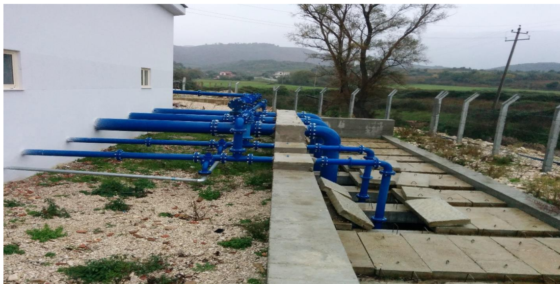
Sistemi i pompimit Tragjas
