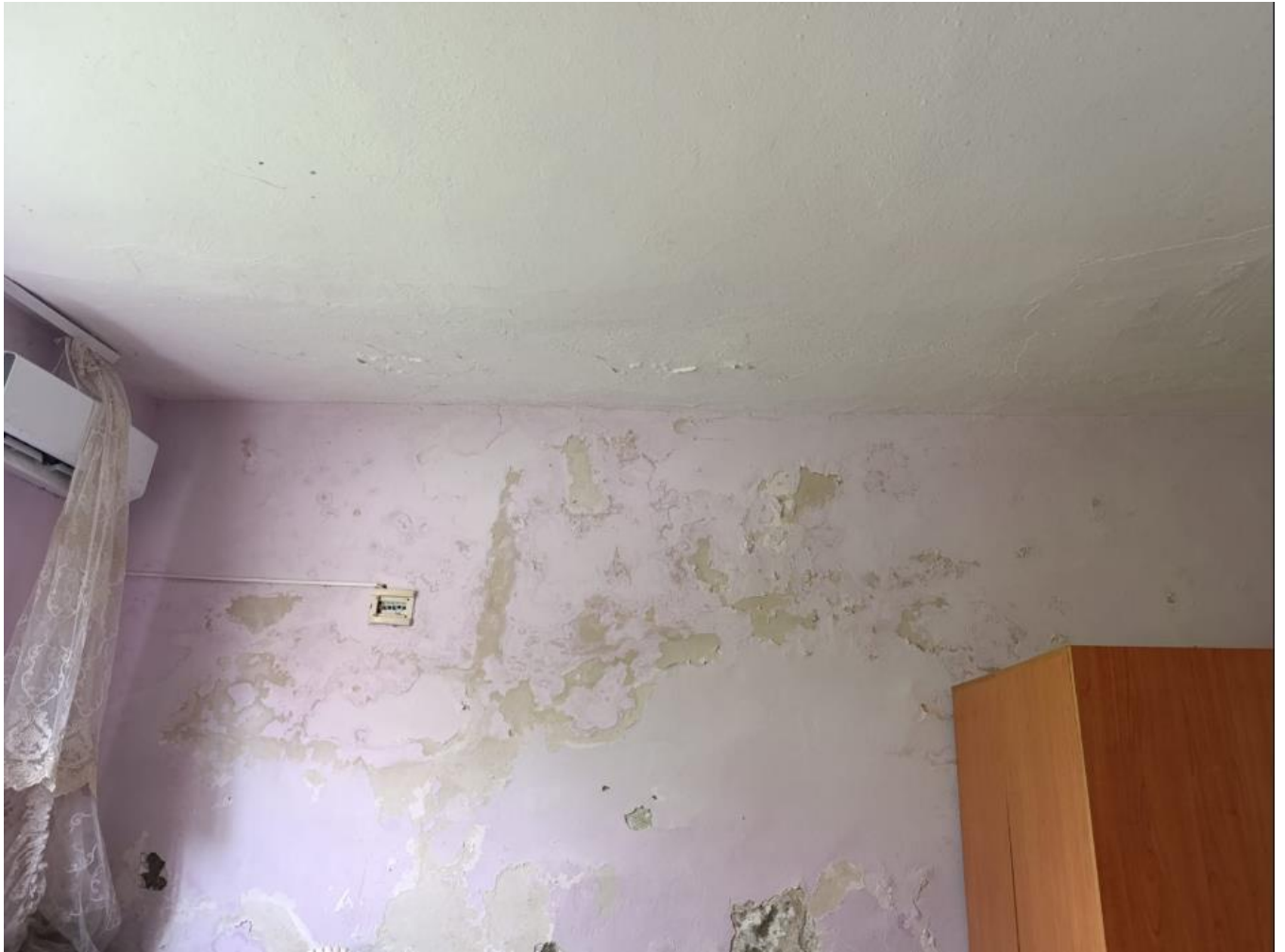
Lageshtire nga problemet me hidroizolimin
